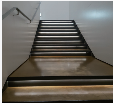
▶ 계단 철타면마다 조명을 설치하여 바닥면을 명확하게 인지 가능
