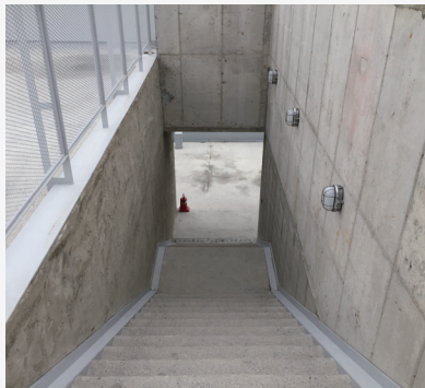
안전 손잡이 미설치 및 계단 식별 어려움
