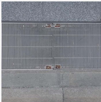
대지경계선에 매립형 배수구를 설치하여 우천 시 대지 내 공간에서 보도로 빗물 침범 방지
